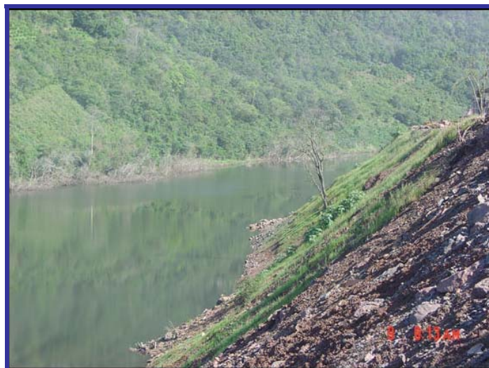
Talude do pátio de ferro/ carpintaria
